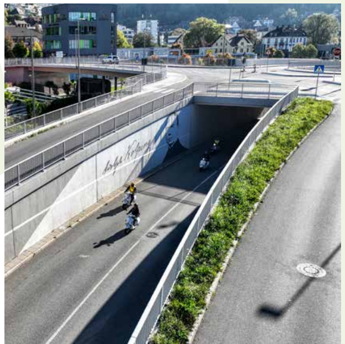
Die Generalsanierung der Kolpingbrücke wurde nach zwei Jahren Bauzeit 2020 beendet. Jetzt ist sie wieder sicher.
